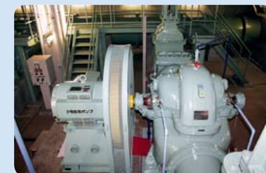
▼地域冷暖房システム用の下水処理水を送る送水ポンプ (花見川終末処理場内)
