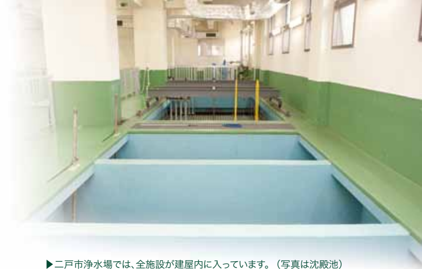
▶二戸市浄水場では、全施設が建屋に入っています。（写真は沈殿池）
