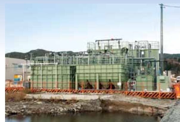
▲写真3 民有地に設置された気仙沼市の仮設污水处理施設
